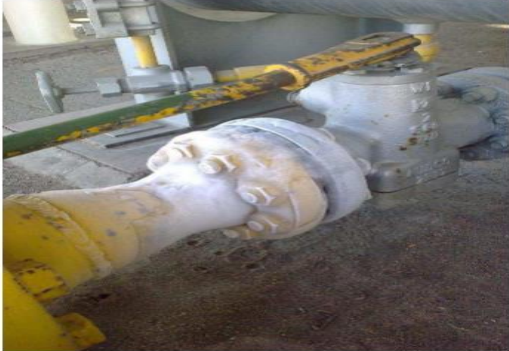
بخ زدگی شیر تخلیه فیلتر ایستگاه تقلیل فشار گاز طبیعی
